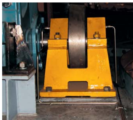
Фото 2 Подвод смазки к подшипнику опорного колеса магнитной грузовой тележки
